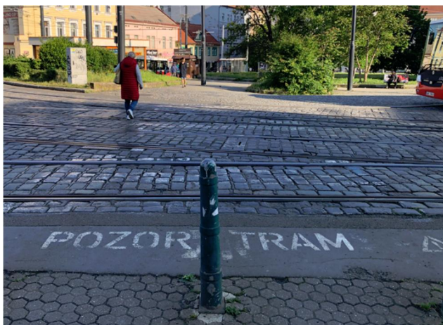
Foto 1. Chybí varovný pás před vstupem do komunikace zóny hmatovou dlažbou
