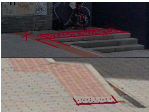
Obr.18 chybně provedený varovný pás nad schody, není lemovaný hladkou dlažbou
