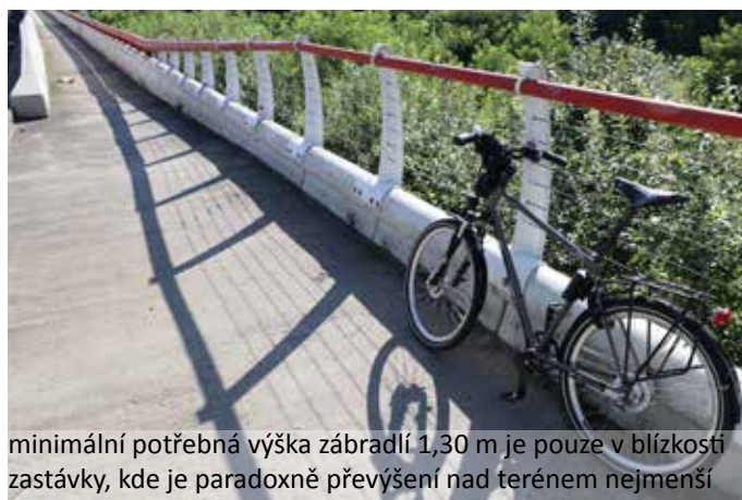
výška a řešení betonového svodidla k TT jsou bezproblémové, ale výška zábradlí 1,10 m není pro legální veřejný přístup optimální ani pro chůzi (kvůli velkému převýšení oproti terénu)
